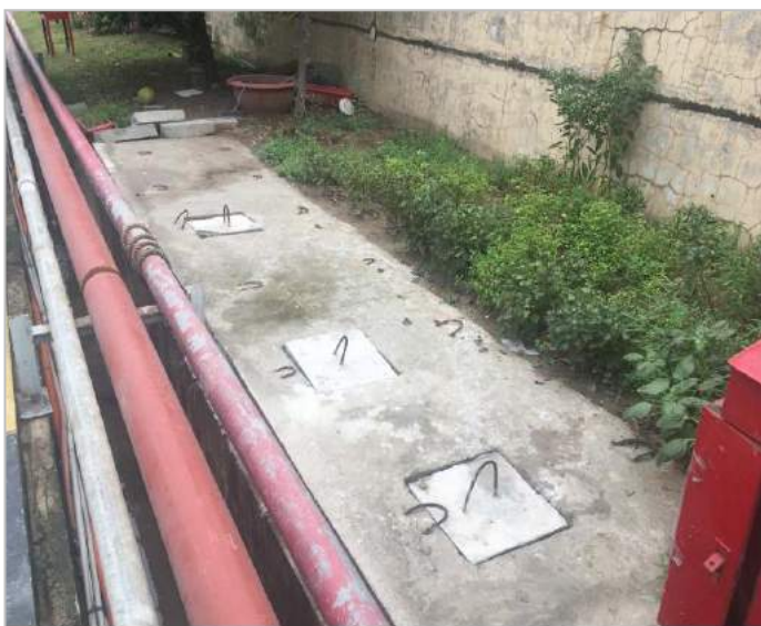
Bể tự hoại, bể tách dầu mỡ và bể khử trùng
